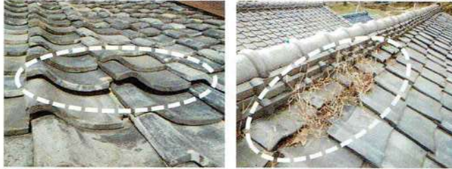
瓦に浮き上がりが生じている
